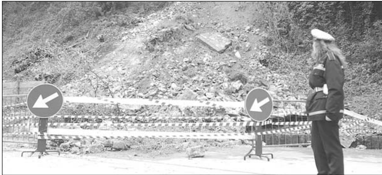
Ancora polemiche sulla frana di Torgiovanetto
